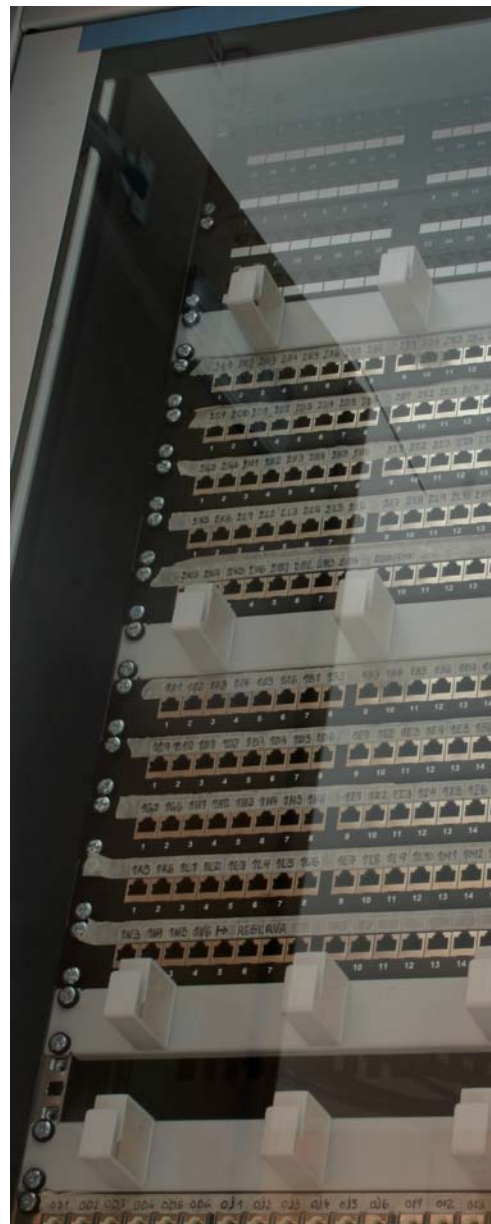
Designação ▶ Concepção e Execução do sistema ITED da Incubadora de Empresas de Mira Ano de Conclusão ▶ 2006 Cliente ▶ Constructora San José
