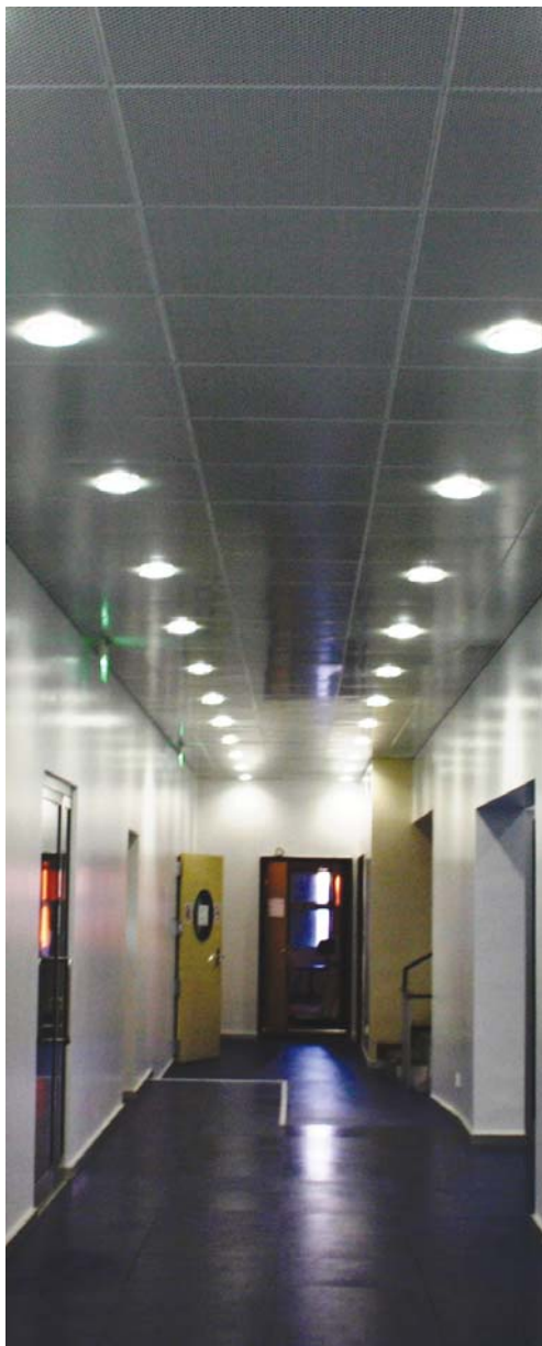
Designação ▶ Concepção e Execução do CPN da RTP Porto do Sistema de Instalação Eléctrica, ITED, Segurança e GTC Ano de Conclusão ▶ 2005 Cliente ▶ RTP / Teixeira Duarte
